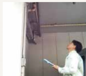
給排水給管、給湯管及びガス管など、共用で使用している設備配管(=共用配管)がちゃんとメンテナンスをされているかを確認
